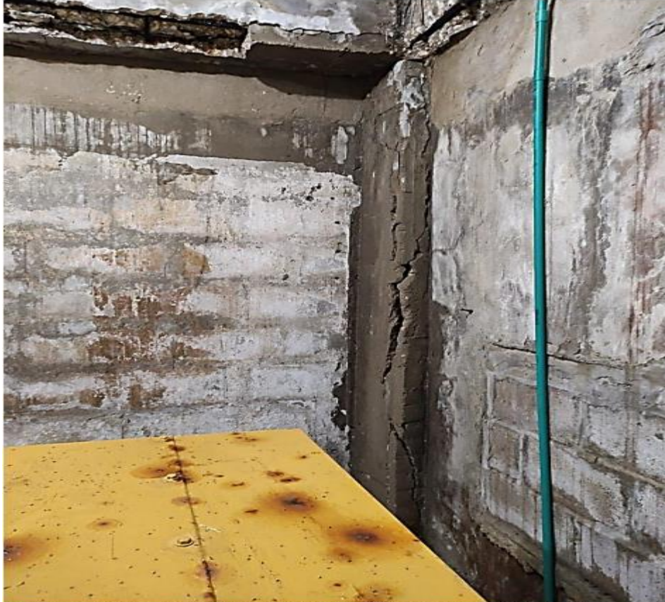
Columna totalmente fisurada por acción del acero corroído en su totalidad.
