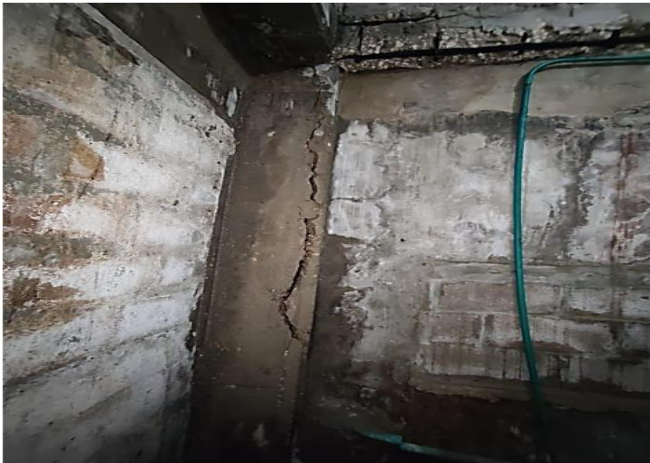
Grieta formada por corrosión acero en columnas de la zona planta eléctrica.
