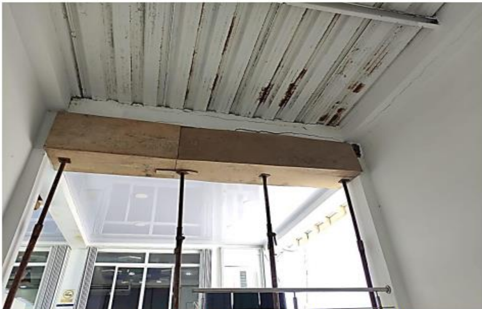
Viga del acceso escalera al 2° nivel, grieta por corrosión acero en 100%
