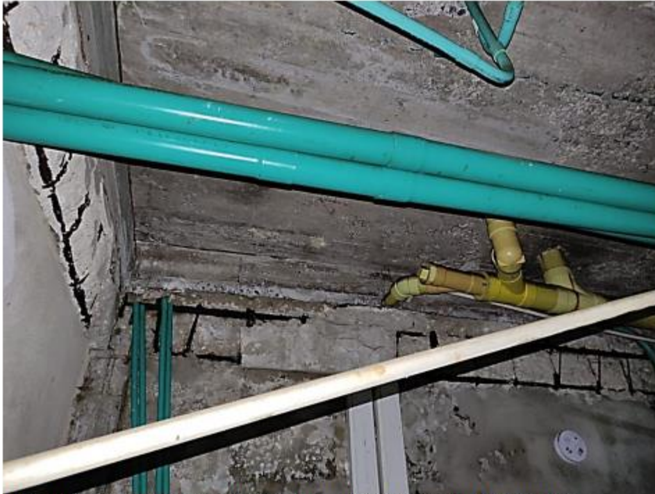
Losa y Vigas en concreto con humedades y sulfatos en más del 90% en el piso 1° zona planta eléctrica.
